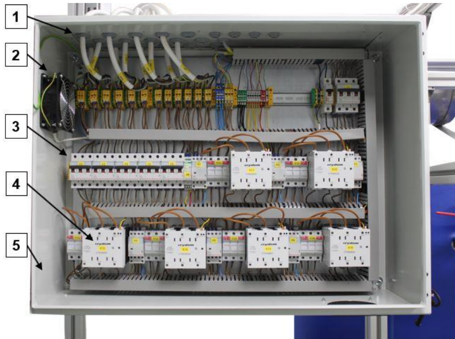
Rys. 6.14. Widok elementów elektrycznych układu zasilania grzałek zasobnika HS 1 – przyłącza doprowadzające energię elektryczną; 2 – wentylator; 3 – zestaw zabezpieczeń elektrycznych obwodów grzałek; 4 – główny element rozłączający obwód grzałki; 5 – obudowa z blachy stalowej
